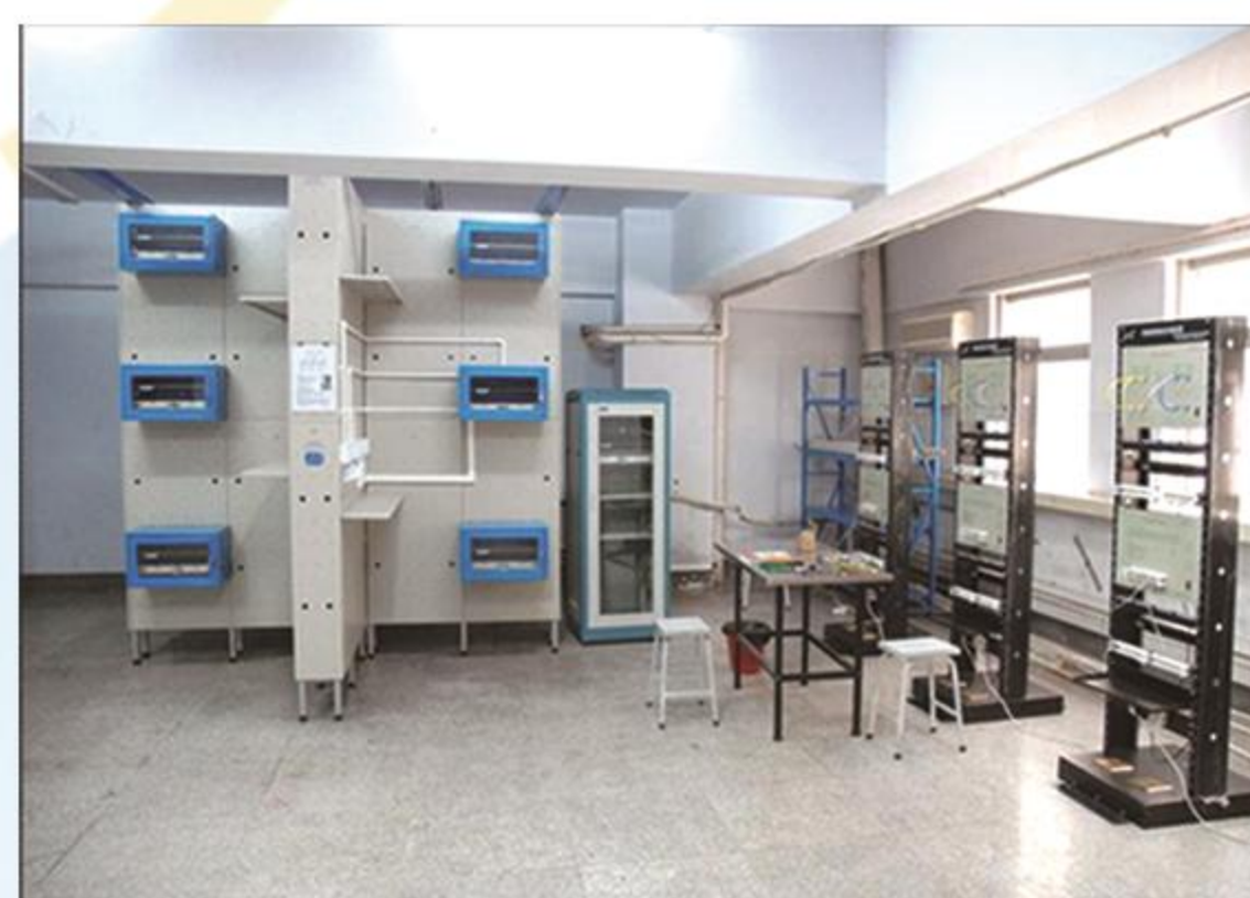
综合布线实训室
